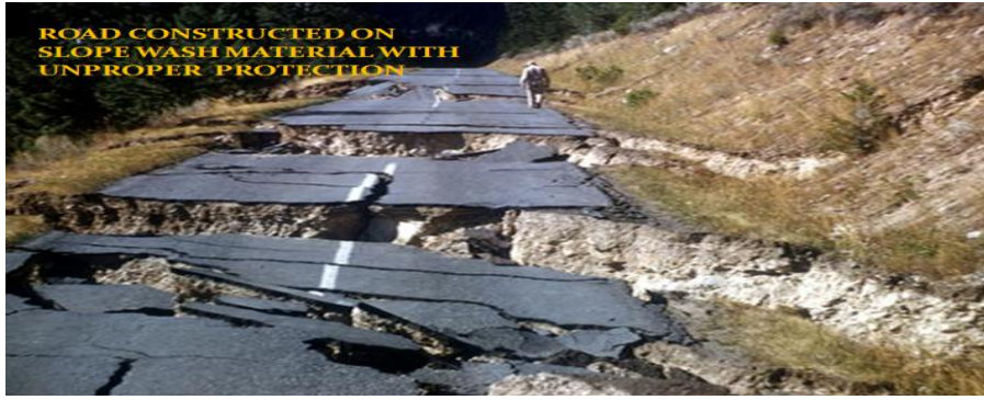
انهيار طريق على منحدر نتيجة لتعرية الصخور تحته ولعدم وجود حماية له
