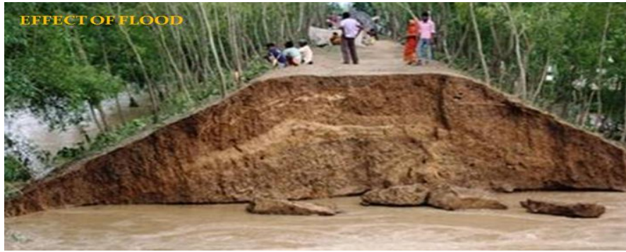
اثر فيضانات المياه
